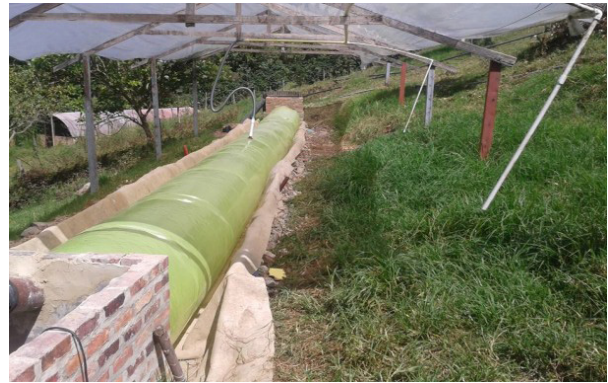
Figure 4. Balloon biodigester in Villa Alicia / Biodigester tipo balón en Villa Alicia
